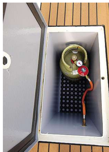
Der Gasflaschenkasten wurde in das Gangbord an Backbord integriert
